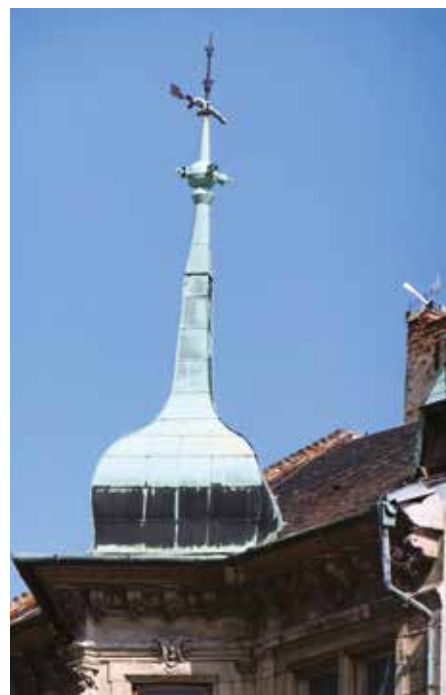
Medená vežička na historickej budove Lekárne u Salvatora v Bratislave. Podobne ako inde aj na nej vidno nerovnomerný progres korózie medi.
